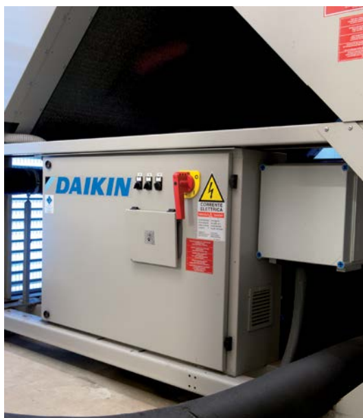
Instalace vzduchem chlazené chladicí jednotky
