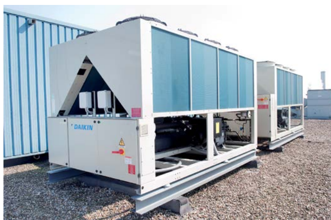
Instalace vzduchem chlazené chladicí jednotky
